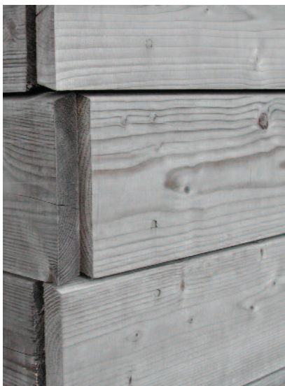
Jernvitriol gir jevn grålig overflate etter noen uker.
