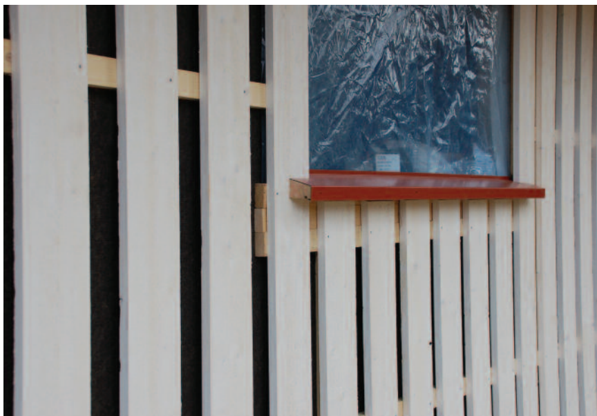
Fabrikgrunnet kledning. Underligger er påført grunning på 3 sider.
